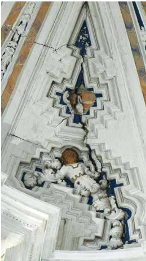
Fig. 3. Desperfectos del interior de la cúpula, anunciando un posible desprendimiento. Foto de Julio Badenes.
